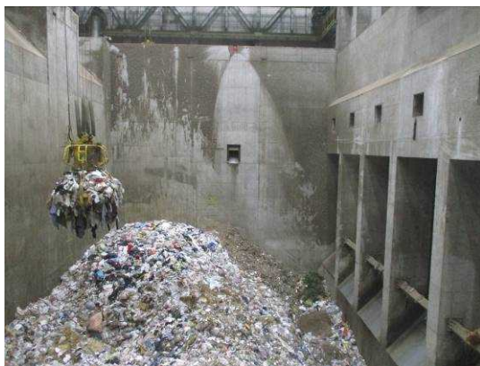
燃せるごみピット内の様子
