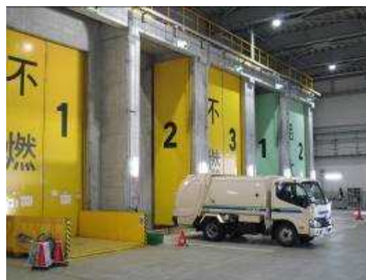
不燃ごみ等の投入ステージ
