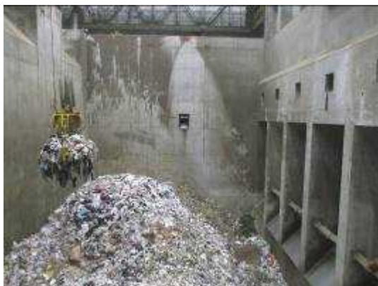
燃せるごみピット内の様子
