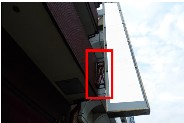
台風により破損した看板
