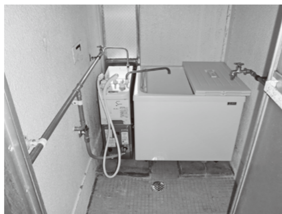
※バランス釜設置後の浴室
