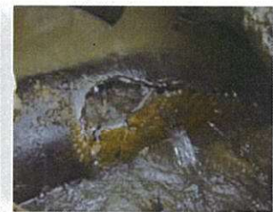
古くなり漏水した水道管
