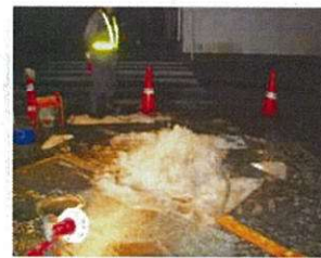
漏水事故現場
