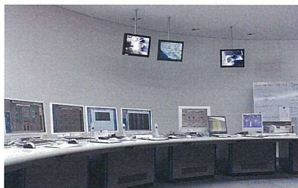
中央監視室 機器の操作や運転の監視を行います。
