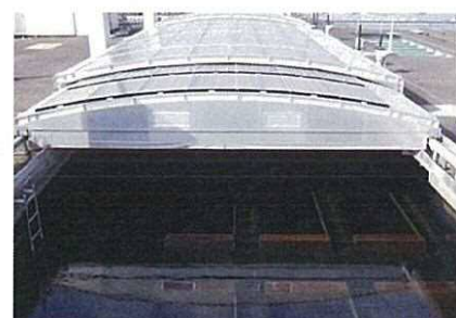
活性炭吸着池
