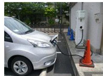
給電中の電気自動車 (EV)
