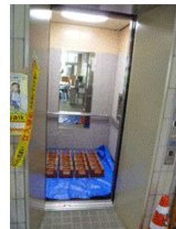
エレベーター内の重り
