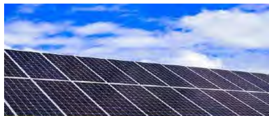
▲①②太陽光発電システム（パネル）
