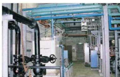
浄化センター内部
