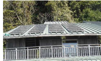
猿島公園 (管理棟に設置された太陽光パネル)
