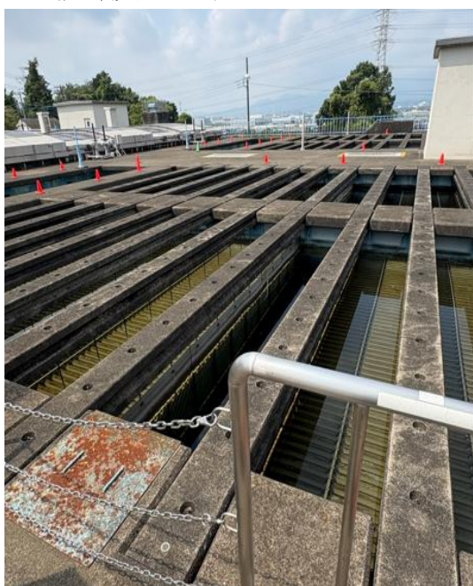
傾斜板沈でん池
