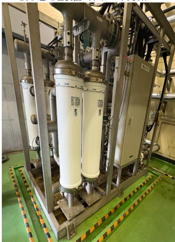
膜ろ過処理装置（令和6年更新）
