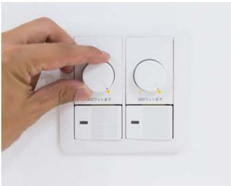
〈照明器具の照度調整〉
