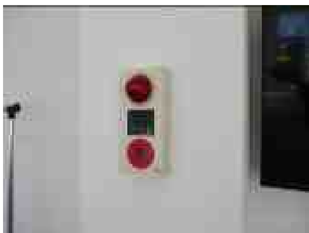
⑰ 火災報知器
