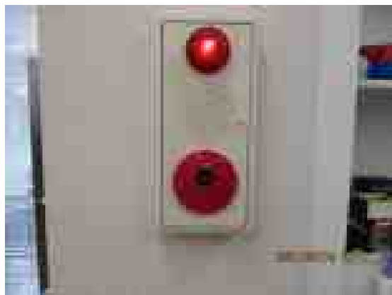
⑭ 火災報知器
