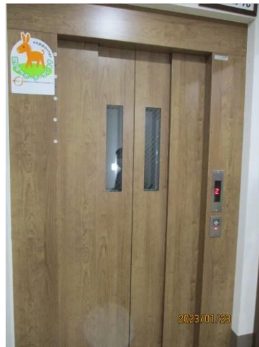
① エレベーター
