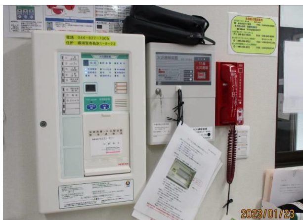
⑪ 火災通報装置
