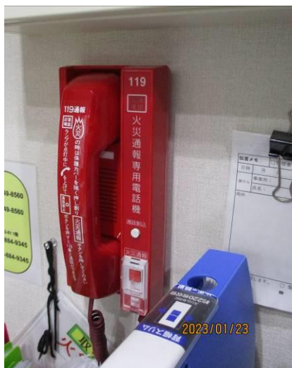
⑧ 火災通報専用電話機
