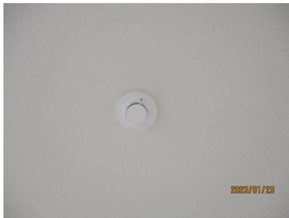
⑬ 火災報知器
