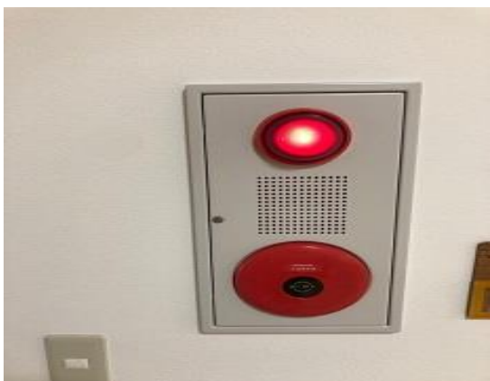
㉓ 火災報知器
