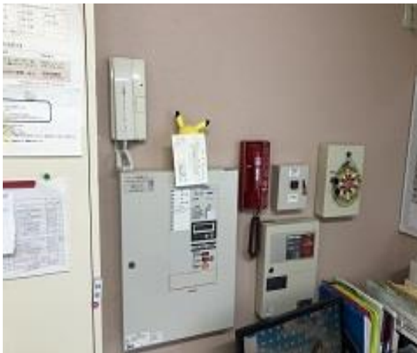
⑦ 火災通報機
