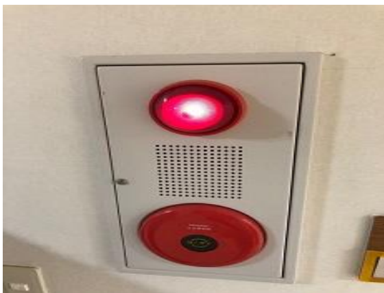
⑬ 火災報知器
