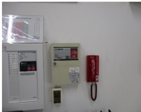
⑫ 火災通報装置
