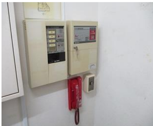
⑦ 火災通報装置
