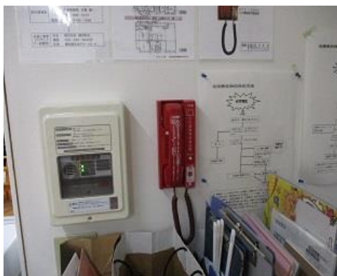
㉑ 火災通報装置
