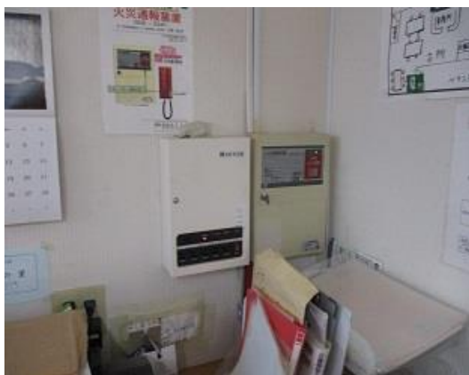
⑦ 火災通報装置
