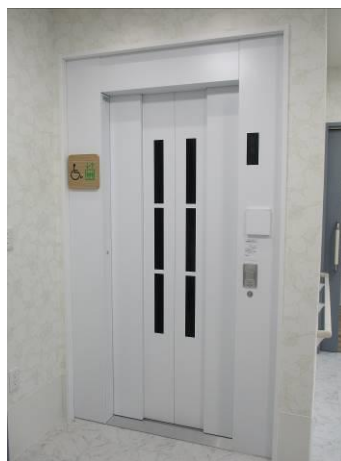
④ エレベーター
