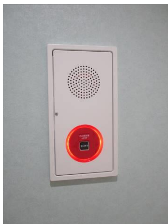
⑰ 火災報知器
