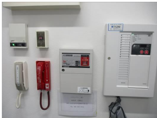
②⑤ 自動通報装置
