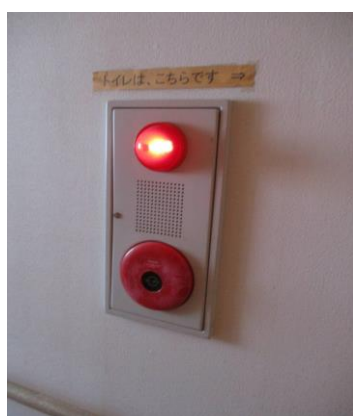
②⑪ 火災報知器
