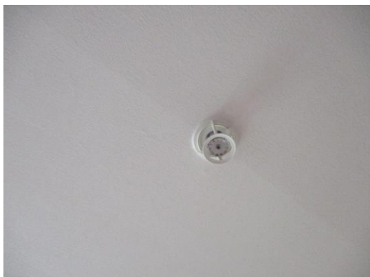
⑨ 居室スプリンクラー
