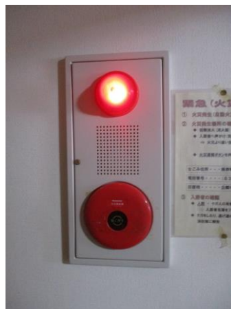
㊿ 火災報知器
