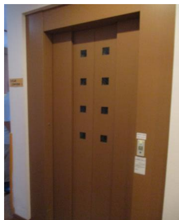
② エレベーター
