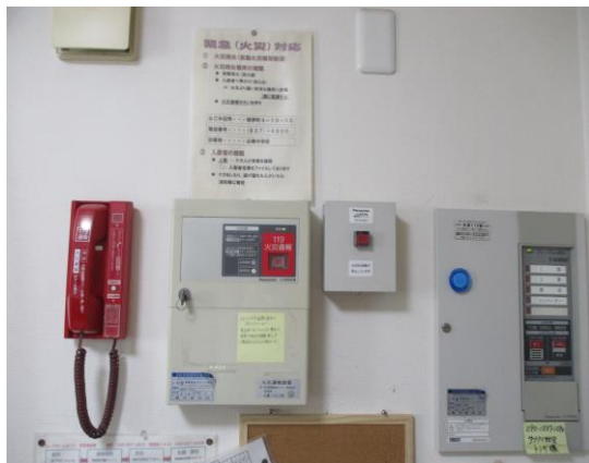
⑦ 火災通報装置
