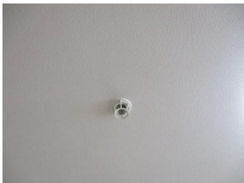
㊹ 食堂兼居間スプリンクラー
