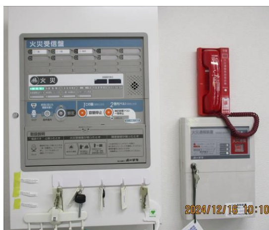
⑮ 火災通報装置
