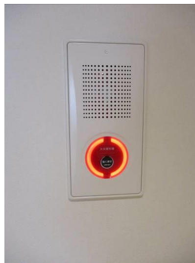
②火災報知器
