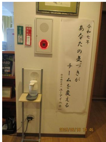
⑮ 火災報知器・手指消毒（玄関ホール）
