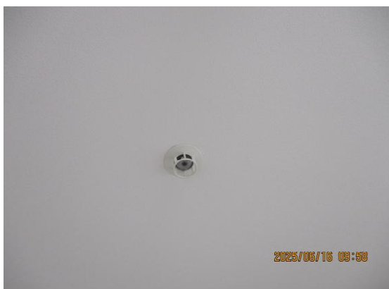
⑰ スプリンクラー（居室）
