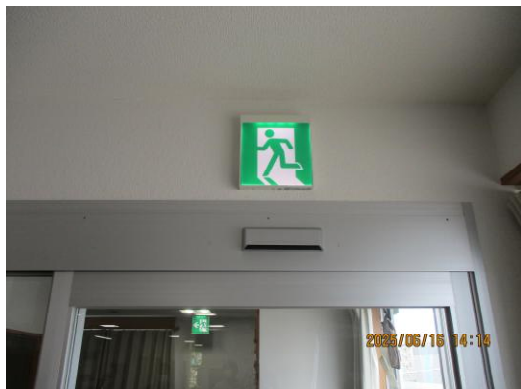
⑰ 誘導灯（玄関上）
