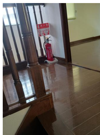
⑱ 消火器（2階）
