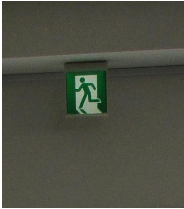
⑬ 誘導灯 (入口)
