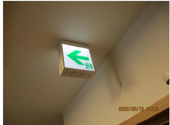
⑭ 誘導灯（ホール）
