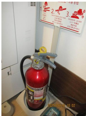
⑮ 消火器（ホール・ロッカー横）
