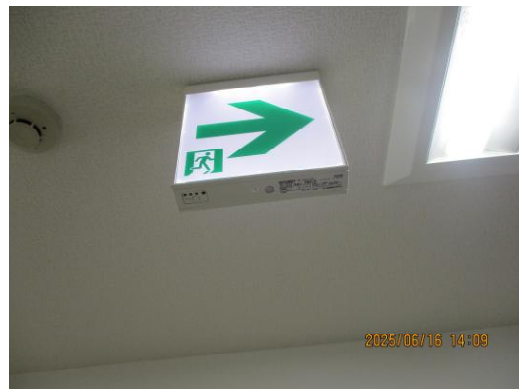
⑱ 誘導灯（廊下）
