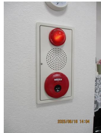
⑯ 火災報知器
