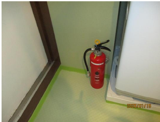
㉑ 消火器 (脱衣場)
