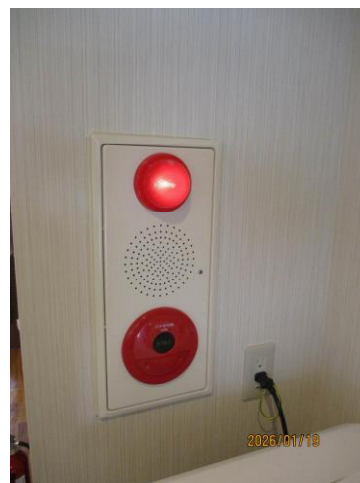
⑱ 自動火災報知機
