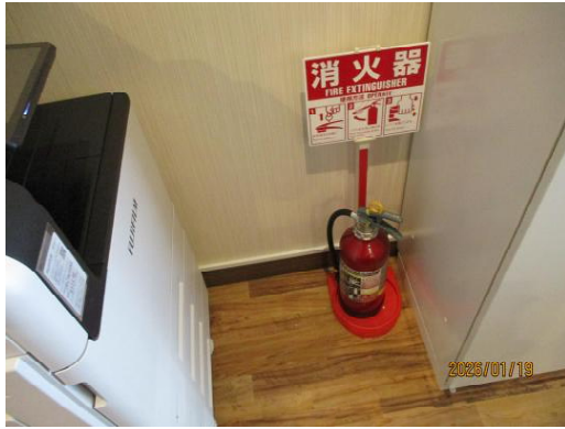
⑱ 消火器 (事務室)
