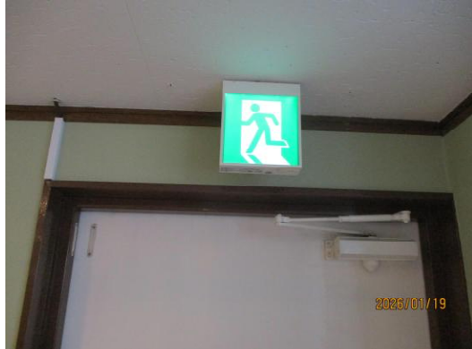
㉒ 誘導灯 (脱衣場)
