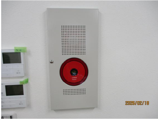
⑱ 自動火災報知器
