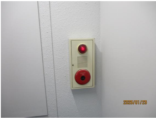
⑮ 自動火災報知器
