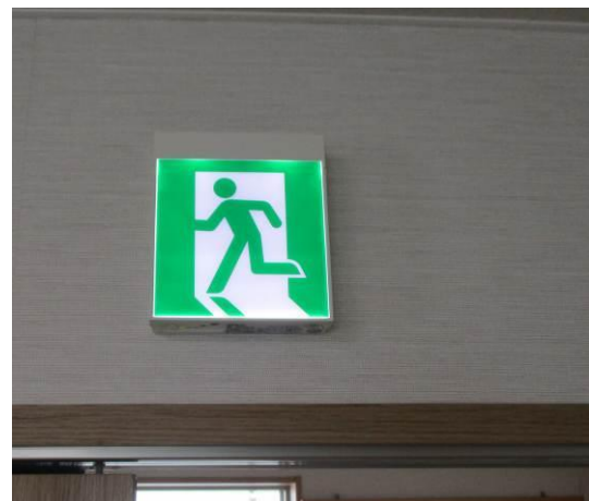
⑱ 誘導灯 (1階)
