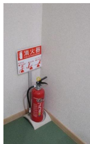
⑫ 消火器（食堂兼機能訓練室）
