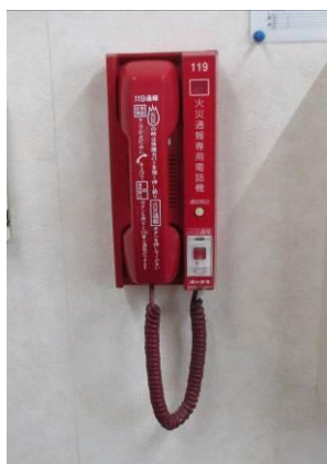
27 火災通報装置 (2階)
