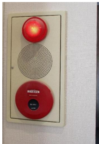
⑯ 火災報知器
