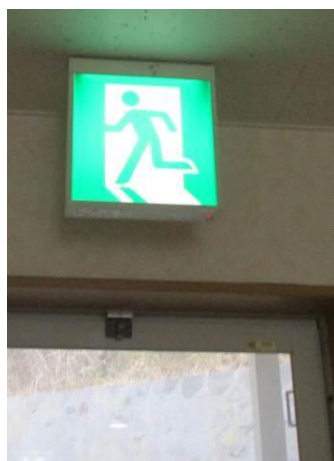
⑮ 誘導灯 (1階)
