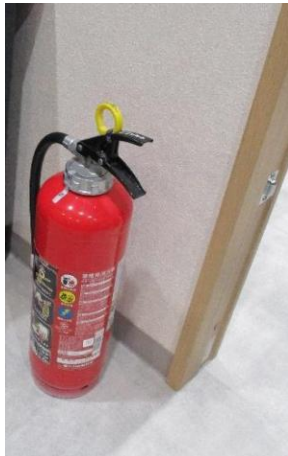
⑬ 消火器（台所）
