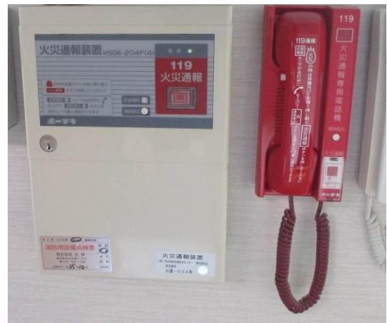
⑯ 火災通報装置
