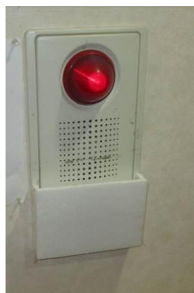
26 火災報知器 (2階)
