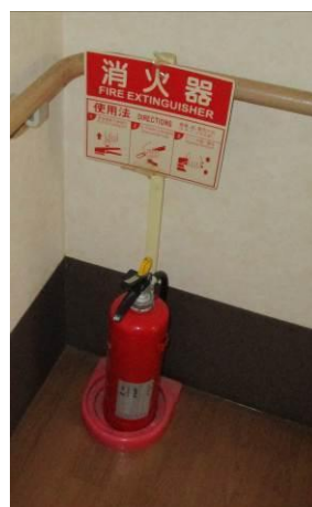
⑫ 消火器 (1階)
