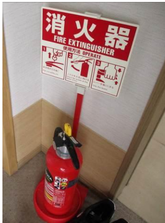
⑬ 消火器 (1階)
