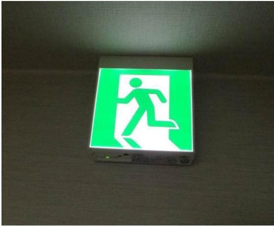
①⑨ 誘導灯（2階）
