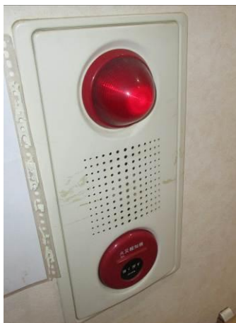
⑬ 火災報知器 (1階)
