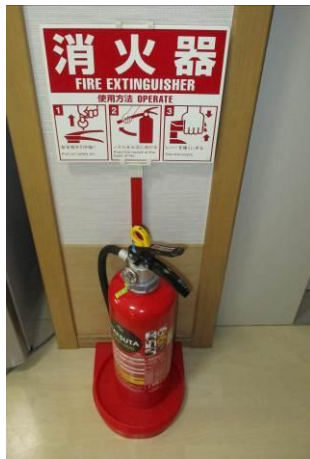
⑮ 消火器 (2階)
