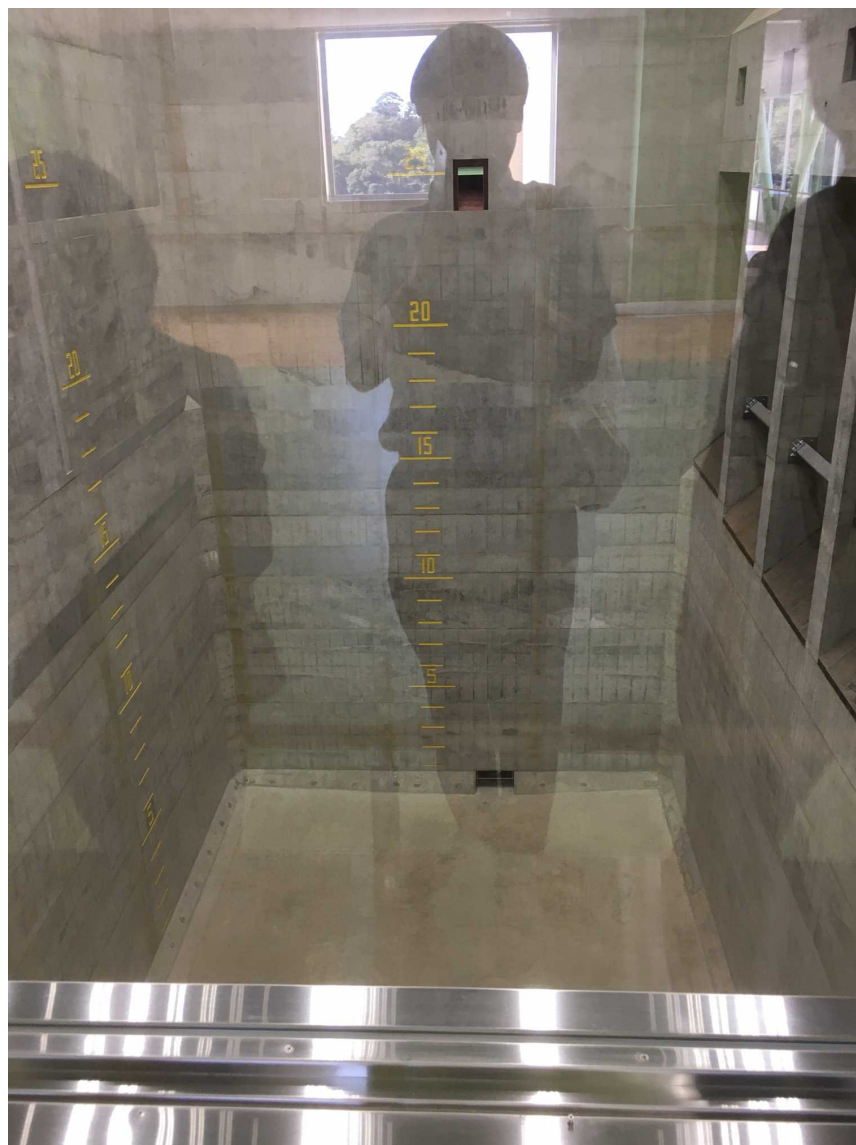
ごみピット比較（ピット空）
