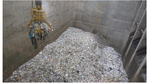
焼却施設のごみピット
