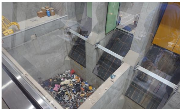
不燃ごみ等選別施設の粗大ごみピット
