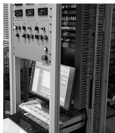
PLCと連動した計測制御システム
