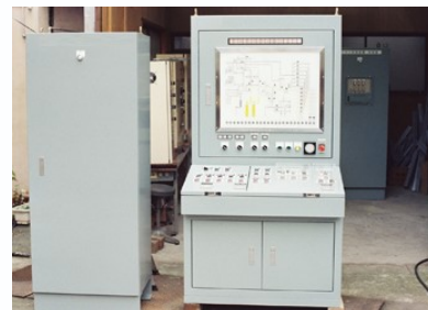
ガス供給制御盤
