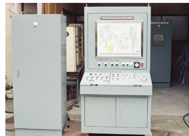
ガス供給制御盤
