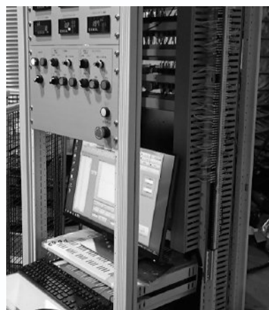
PLCと連動した計測制御システム
