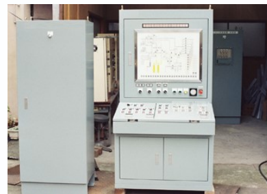
ガス供給制御盤
