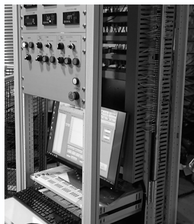
PLCと連動した計測制御システム
