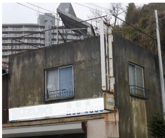
破損・汚損している広告物が掲出されている店舗があった
