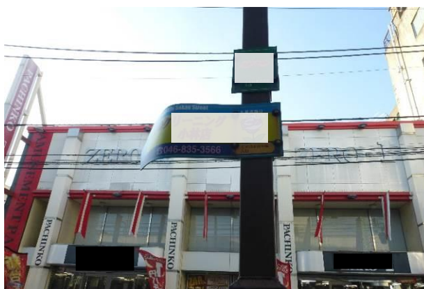
街路灯に設置されている広告物で一部破損しているものがあつた
