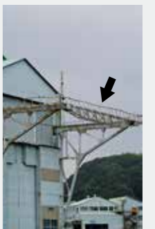
外にせり出したクレーンのレール
