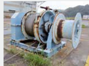
ゲートを引き上げるウインチ
