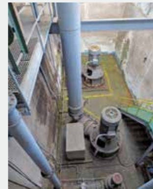
現存する電気式ポンプ
