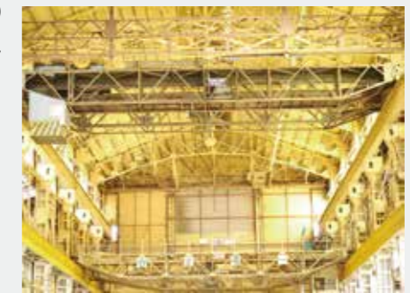
50ト天井走行クレーン
