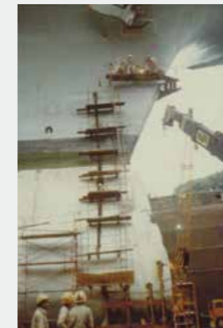
破損した艦首(ドック入り直後)
