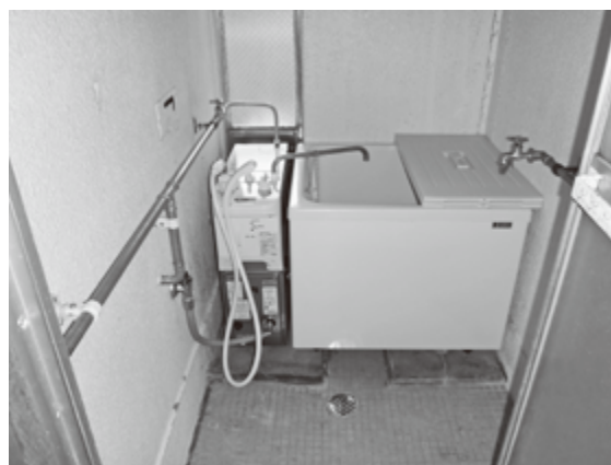
※バランス釜設置後の浴室
