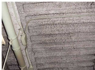
石綿含有吹付けロックウール
