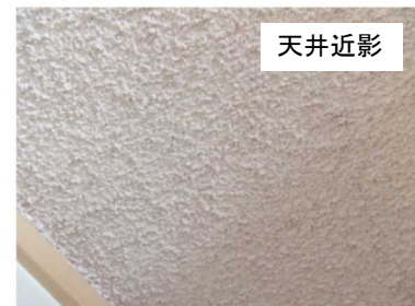
石綿含有パーライト吹付
