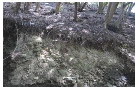
前田川上流部左側法面の 岩盤の上の薄い表土（秋谷）
