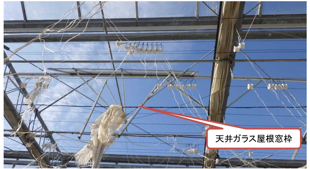
天井状況②
