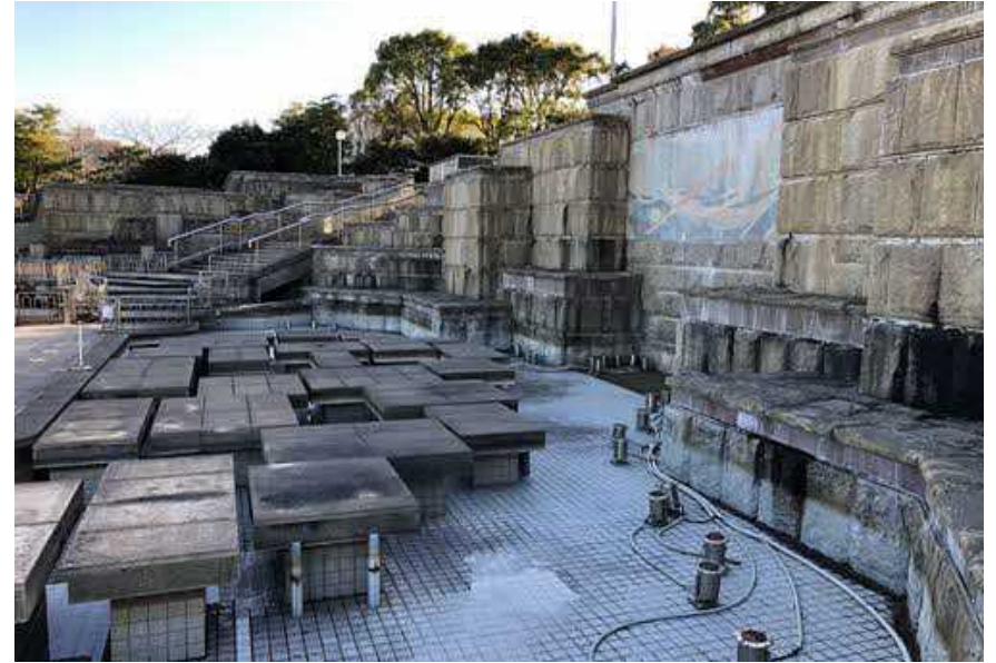
②現状利用されていない壁泉
