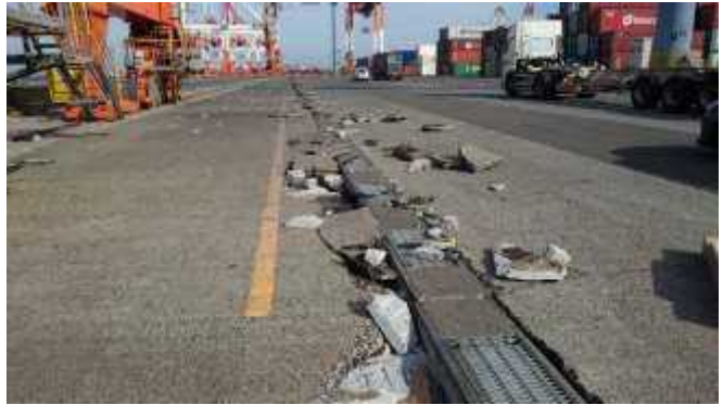
グレーチングの全損
