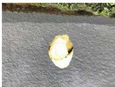
栈橋フロートの損傷（補修前）
