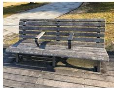
芝生広場のベンチの補修（補修前）
