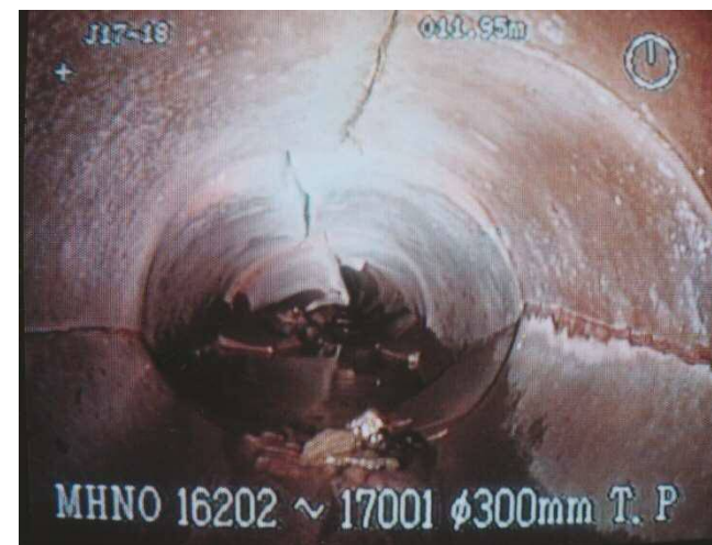
破損した下水管
