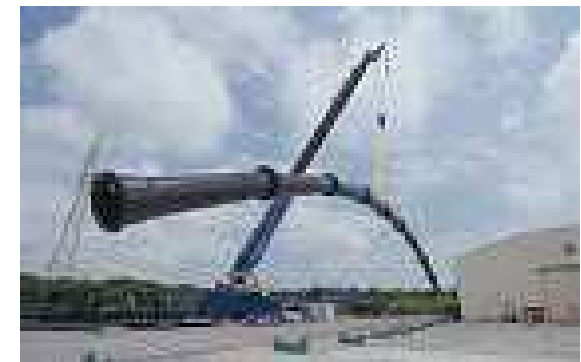
耐震性能を持った水道管 14
