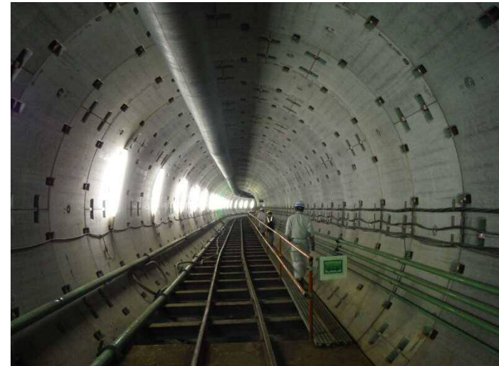
追浜地区雨水バイパス管
