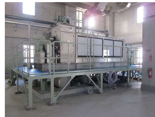
更新時は高効率な機器に 写真：汚泥脱水機設備（下町）
