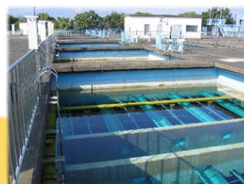
有馬浄水場ろ過池
