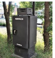
自動水質監視装置
