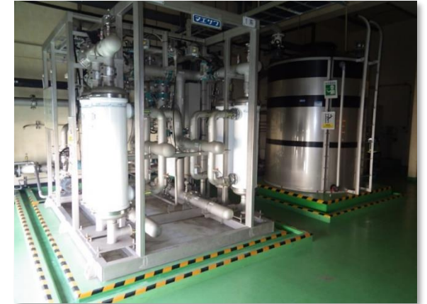
膜ろ過設備（走水水源地）
