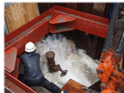
大口径の漏水現場
