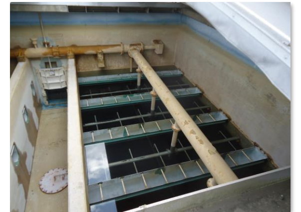
二層ろ過池（有馬浄水場）
