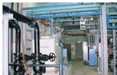
浄化センター内部
