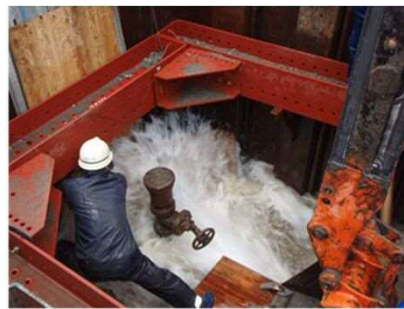
大口径水道管の漏水現場
