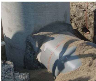
耐震性能のない下水道管の接続部分 (マンホールに固定されている)
