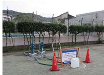
学校での応急給水拠点開設
