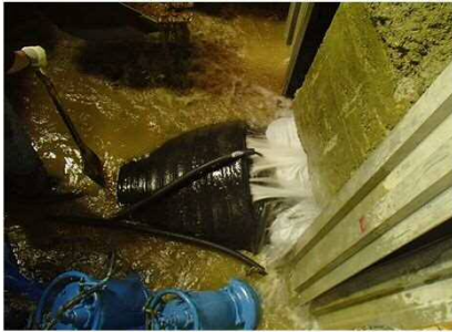
耐震性能のない水道管 (接続部分からの漏水)
