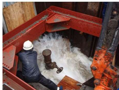
大口径水道管の漏水現場
