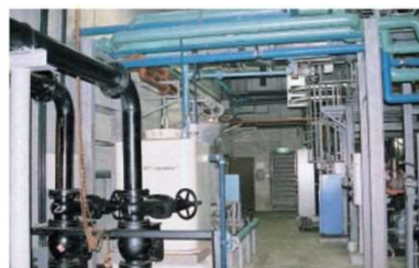
浄化センター内部
