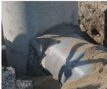
耐震性能のない下水道管の接続部分 (マンホールに固定されている)
