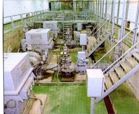
大矢部ポンプ所
