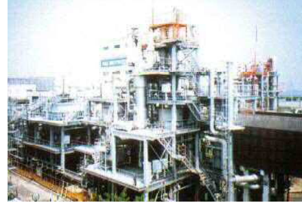
汚泥焼却炉（下町浄化センター）
