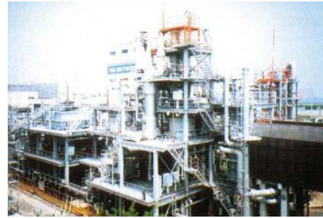
汚泥焼却炉（下町浄化センター）
