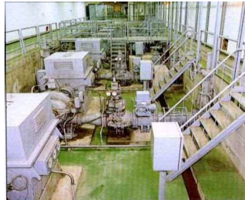
大矢部ポンプ所
