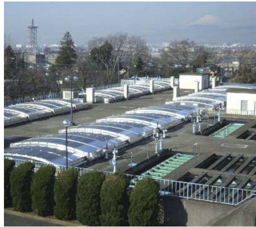
有馬浄水場太陽光発電設備
