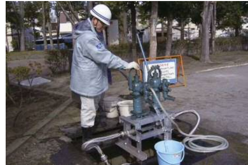
非常用応急給水ポンプ
