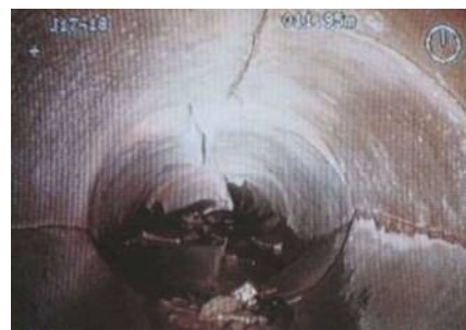
下水道管の破損
