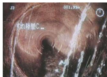
下水道管の破損による浸水
