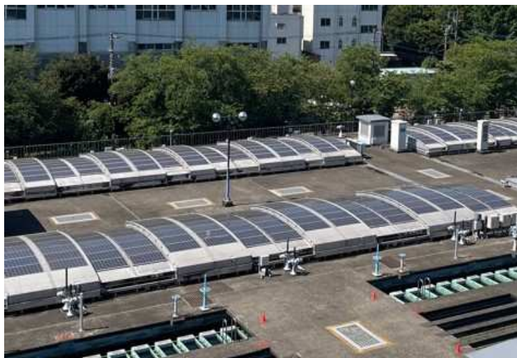
有馬浄水場ろ過池太陽光発電設備更新
