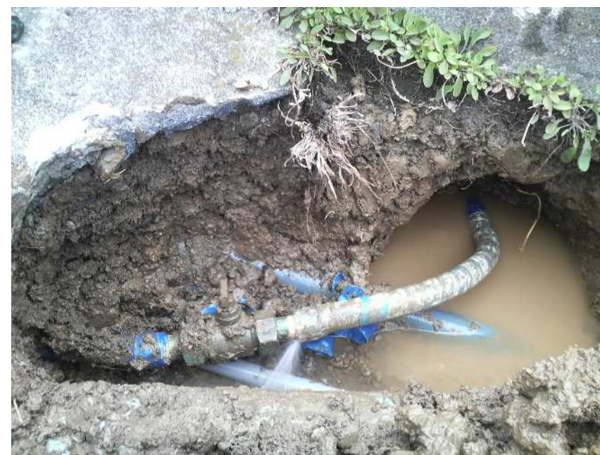
鉛給水管の漏水状況
